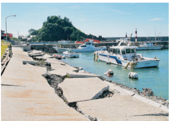
海底が隆起して船が出られなくなった高屋地区の港
